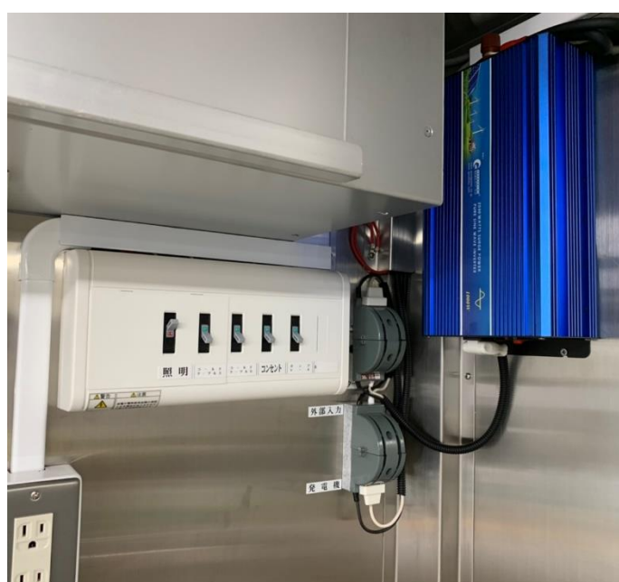
分電盤 インバーター
