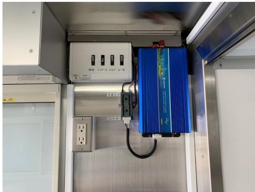
分電盤 インバーター
